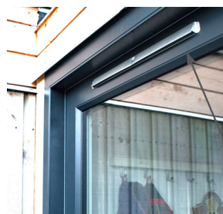
Ventilspalte i hoveddøren.
