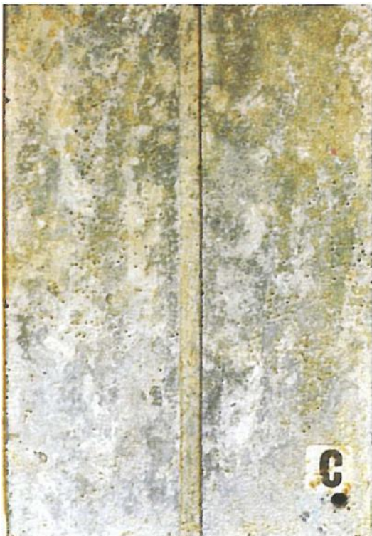
Et 6 mm bredt fræset spor gennem en 60 µm tyk zinkbelægning på stål og eksponeret i 5 år i svært Industrimiljø i Holland. Bemærk belægningen af zinksalte i sporet der er uden rustangreb. (Foto: J F H van Eijnsbergen).
